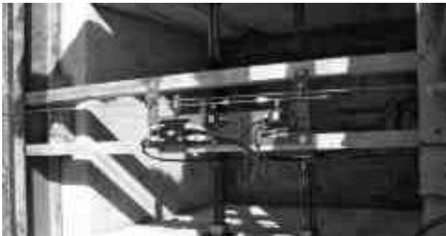
Elektrische Pfeiler-Überwachung Für den Pfeilerkopf
